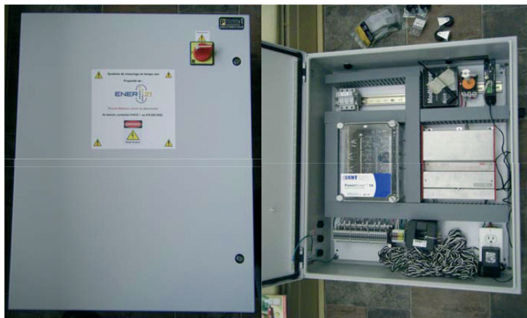
Figure 27 : Panneau de contrôle du système de mesurage
