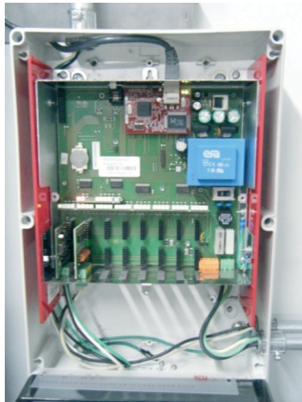
Figure 36 : RTU pour communication Internet, stockage local de données et communication MODBUS aux compteurs
