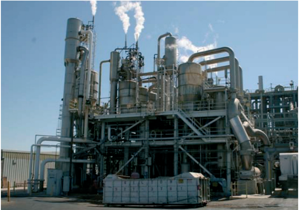
Figure 30 : Système à recompression mécanique des vapeurs
