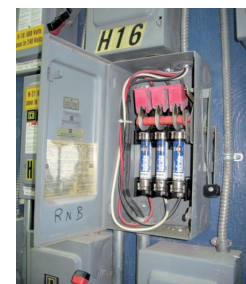
Figure 26 : Panneau électrique de l'ancienne presse
