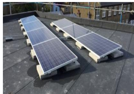
Figure 5: Châssis lestés sur une toiture
