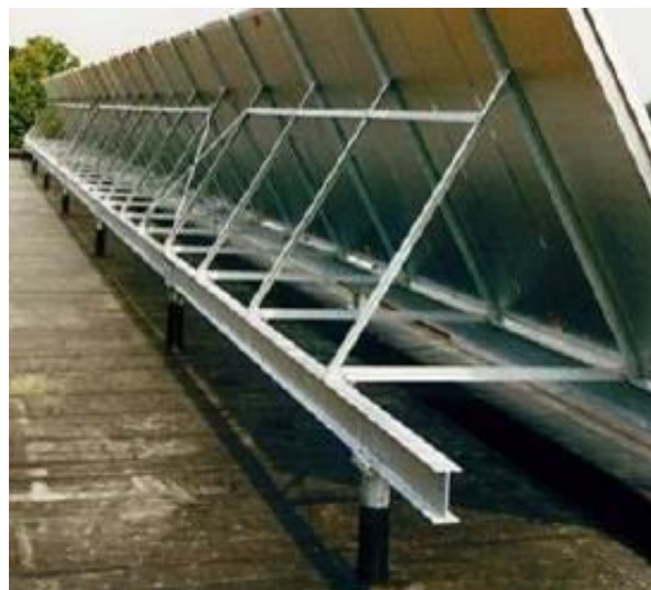
Figure 6: châssis ancré sur une toiture
